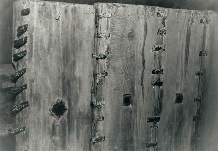
Abb. 6: Ackerklause. Detail des Schlagtor-Flügels mit der Abdichtung der Stoßfugen. Sichtbar sind hier die Dreikantleisten (genannt ‚Zaine‘), welche durch eiserne Klammern (genannt Klumperl) gehalten werden. Zustand 1986 (Foto: Franz Federspiel).
