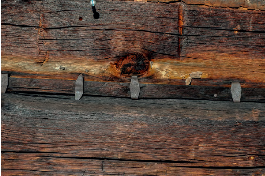
Abb. 9: Wimmeralmhütte auf der Zimnitz, Bad Ischl. Detail der Abdichtung der Fugen. Zustand 2017 (Foto: Thomas Nussbaumer).
