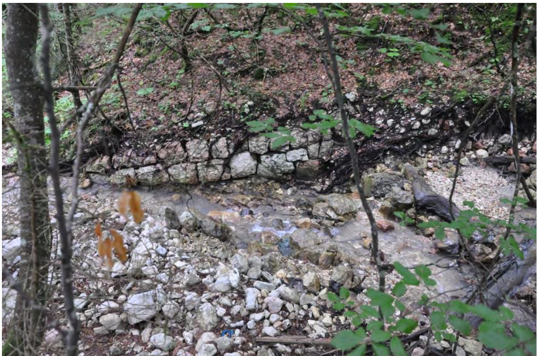
Abbildung 46: Steinbergbachverbauung, Rest einer Längsverbauung, Quadermauerwerk, 1078m N47°33,925' E13°37,717', Aufnahme Idam 2014
