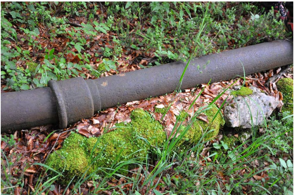
Abbildung 53, Wasserableitung Gusseisen auf Trockenmauerwerktrasse Salzberghochtal, 1162m N47°34,012' E13°37,478'
