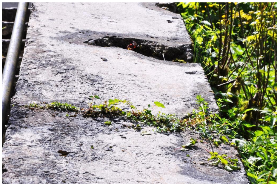
Abbildung 36, Dehnungsriß und Frostausschlag in einer Mauerkrone aus unbewehrtem Beton, Hallstatt. – Foto Idam.
