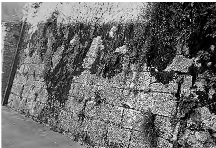
Abb. 4: Stützmauer Hallstatt, Mortonweg (Foto: Idam)
