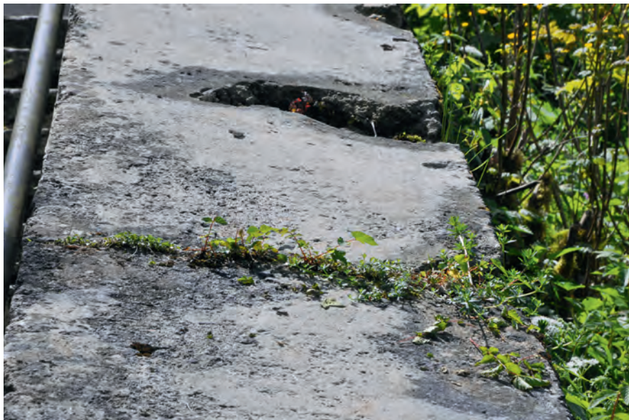
Abb. 36: Dehnungsriss und Frostausbuch in einer Mauerkrone aus unbewehrtem Beton, Hallstatt (Foto: Idam).
